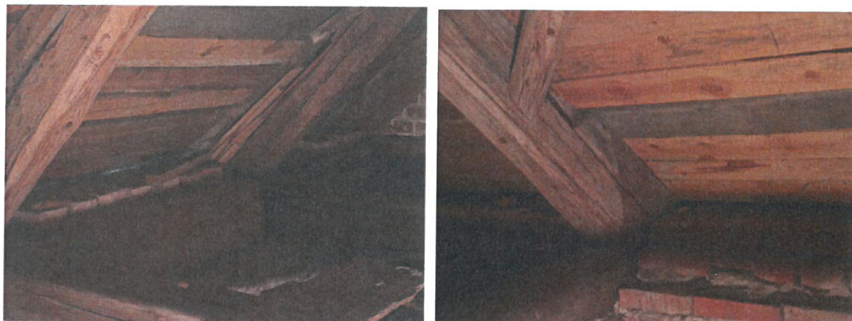
Rys. 4. Widok więźby dachowej opartej na belce (występujące zawilgocenia i zagrzybienia). Widok zniszczonego muru w miejscach oparcia na murze.
