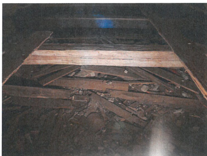
Rys. 5. Widok śmieci leżących na sklepieniu.
