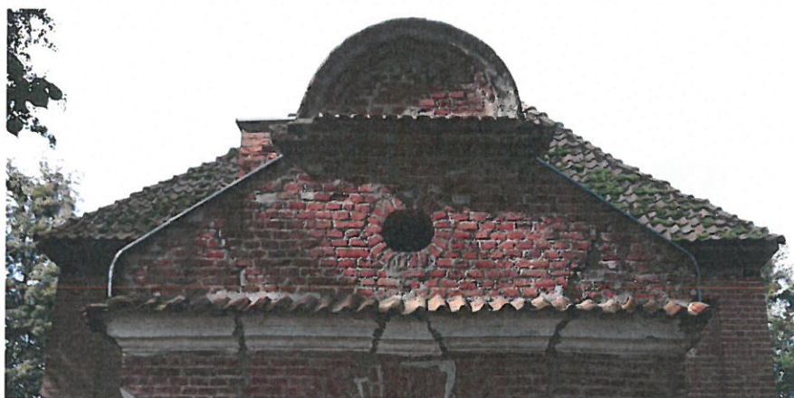
Rys.10. Widok zniszczenia nadproża oraz ściany szczytowej zakrystii od strony zewnętrznej.
