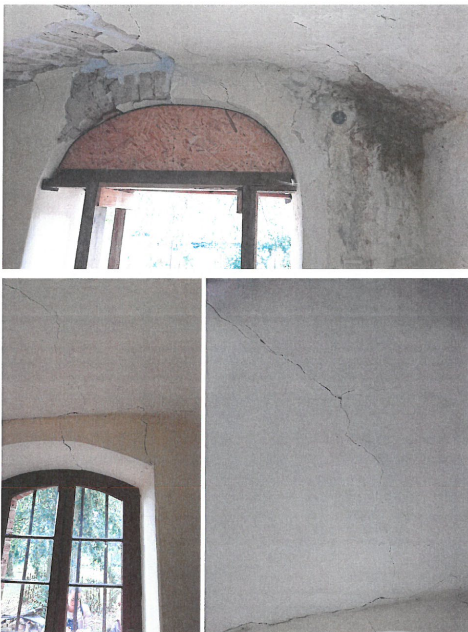
Rys. 9. Widok zniszczeń sklepienia oraz ścian po wykonaniu wstępnych prac zabezpieczających
